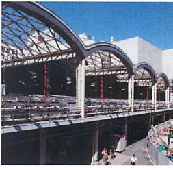
2013年、旧東横線渋谷駅舎のかまぼこ屋根が解体される。写真提供:東急電鉄
